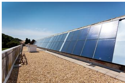
Les capteurs solaires installés en toiture Crédit photo : Bruno Pantel/ADEME
